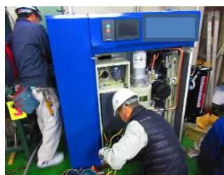
電源に電気が来てない
