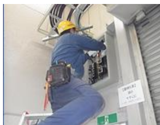
ブレーカーの増設・減設
