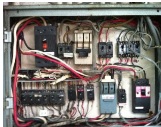
ブレーカーが故障中
