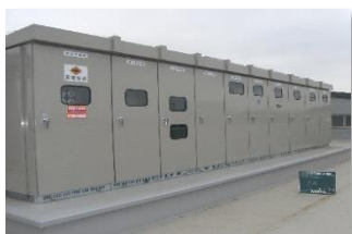
受変電設備の更新
