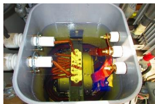
トランスオイルの交換
